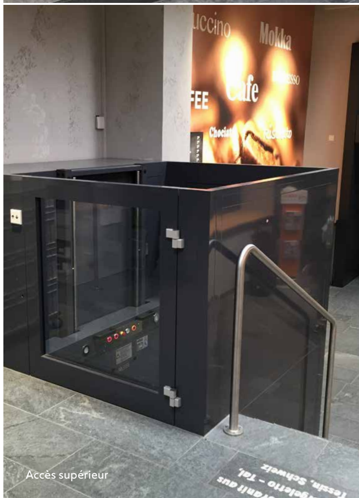
Lift installé dans un centre commercial
