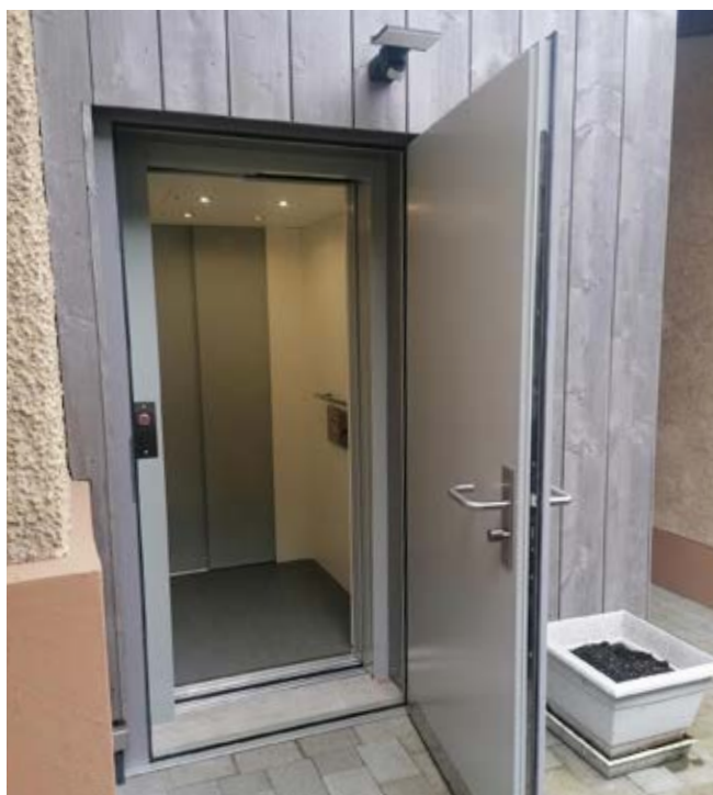
Ascenseur à porte coulissante ouverte derrière une porte d'accès isolée
